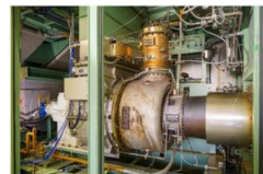
【アンモニアガスタービン】
